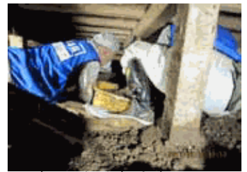
床下の泥を掻き出し
