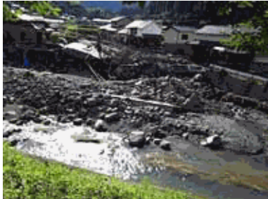
大鶴地区の氾濫箇所
